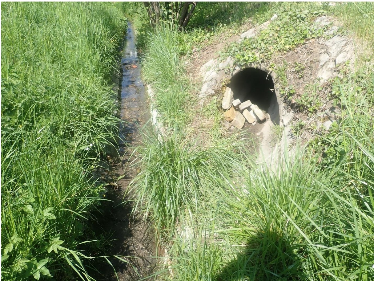
Abbildung 15: Einleitungsstelle des RÜB 8.6 Nordhausen
