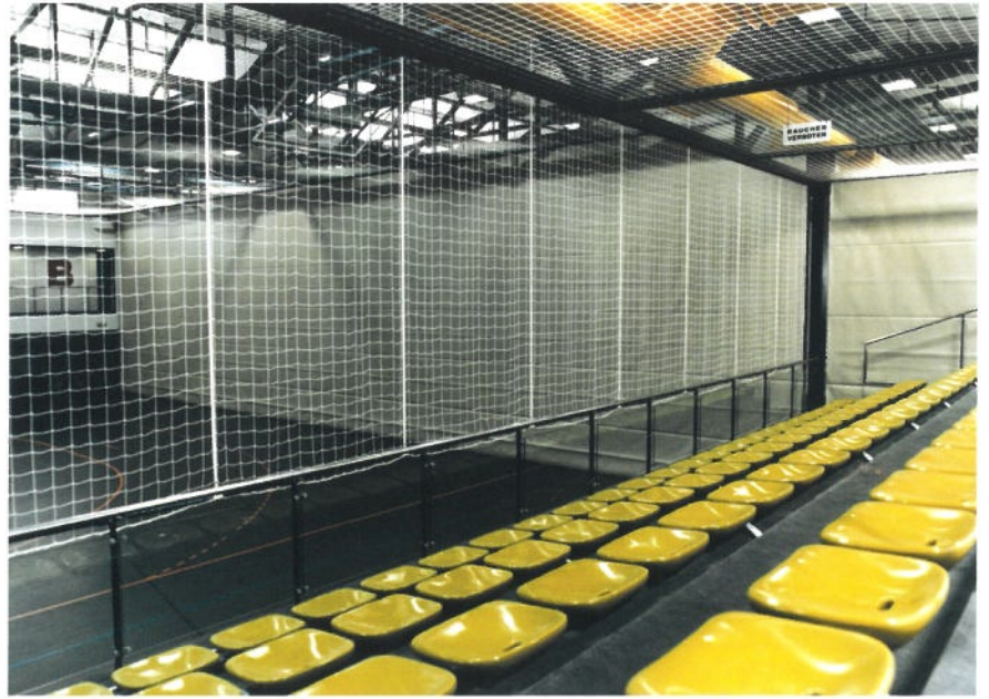
Ballschutznetz und Deckenverspannung
