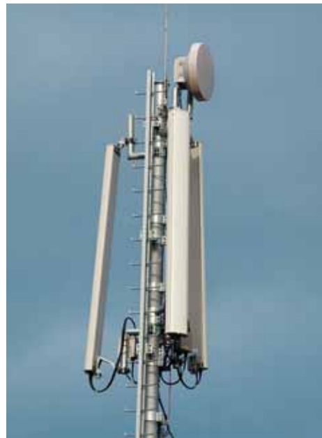
Antennenkonstellation einer typischen Mobilfunkbasisstation mit drei Sektorantennen.
