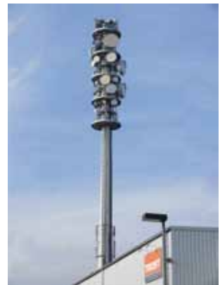
Richtfunkantennen auf einem hohen Turm in Karlsruhe
