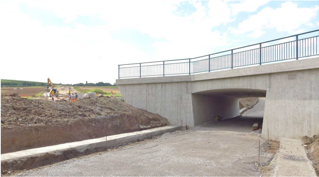
Die Geh- und Radweg-Unterführung ist nahezu fertig. Bald schon wird sie zur Nutzung freigegeben.
