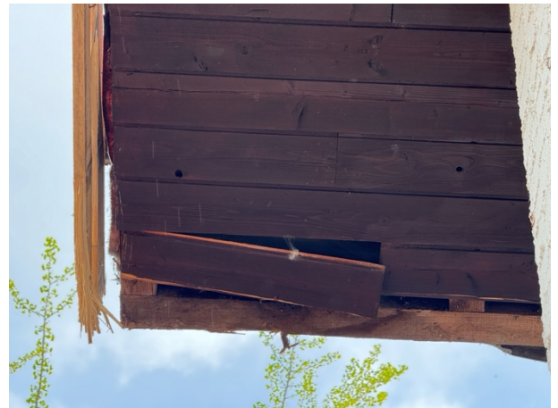
Abb. 11: Durch Maschineneinsatz verursachte schadhafter Dachüberstand im Südosten des Gebäudes.
