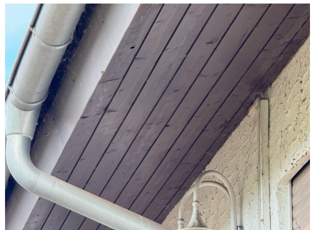
Abb. 7: Dachüberstand an der Gebäudenordseite ohne freitragende Balken und Spalten.
